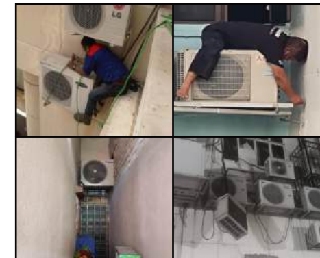
Rajah 7.8: Pemasangan yang Salah
